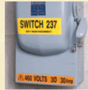
Identificador de Painel e Disjuntor
